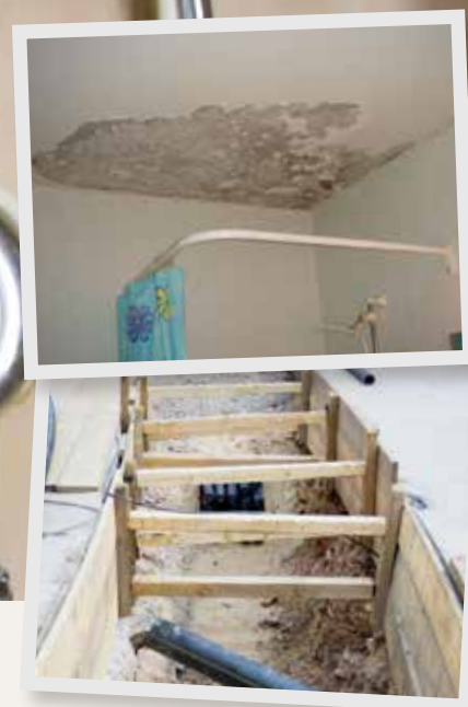
Att dröja för länge med renoveringar kan ge upphov till allvarliga skador på byggnaderna – det lönar sig att underhålla i god tid.
